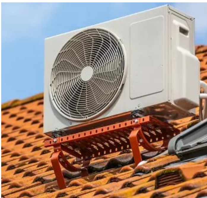
Jednostka zewnętrzna zamontowana na dachu ze spadem.
