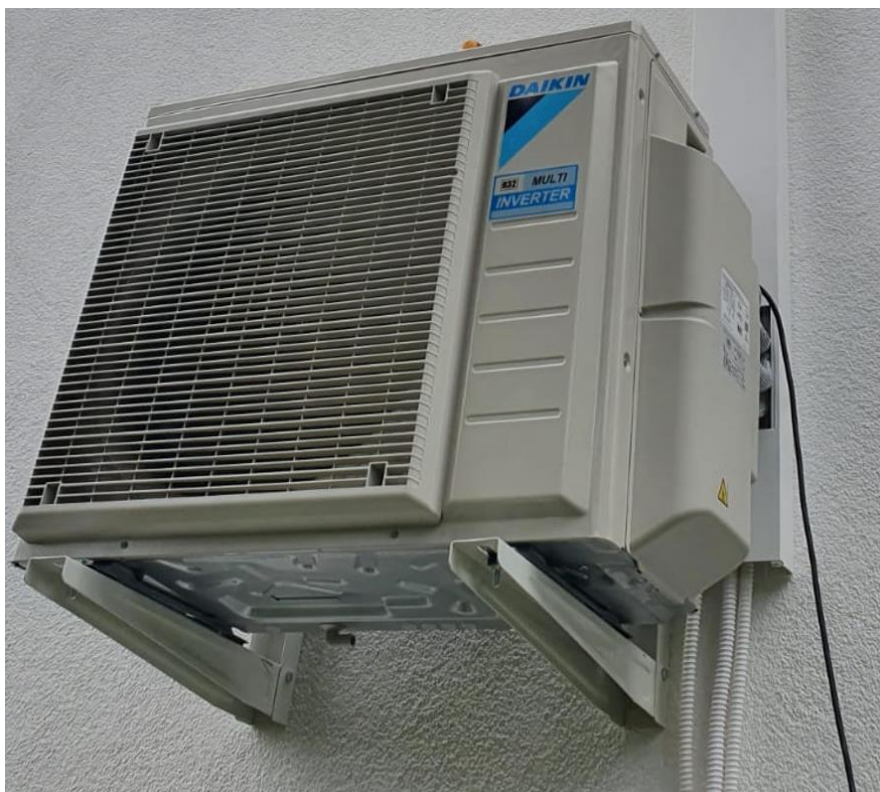
Jednostka zewnętrzna zamontowana na ścianie budynku
