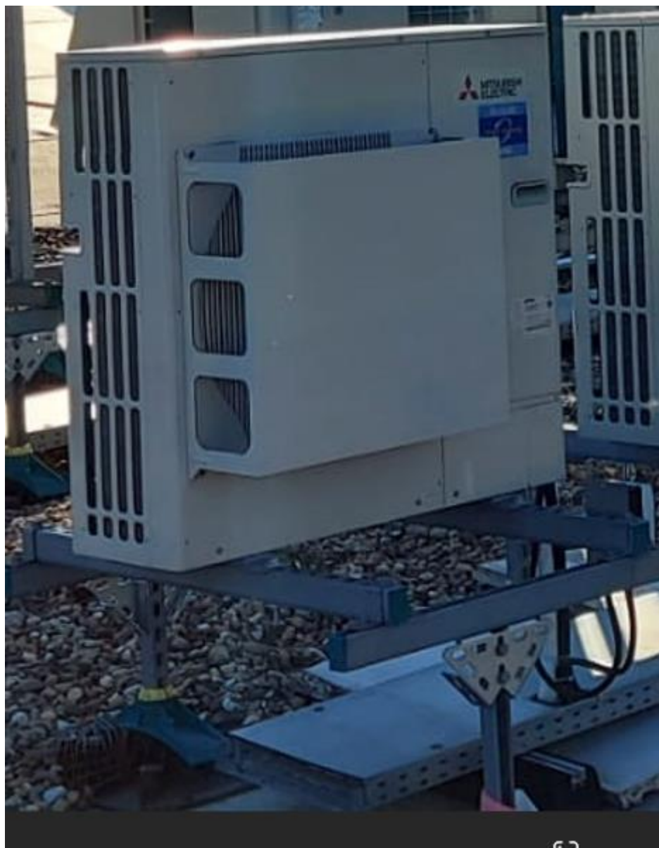
Jednostka zewnętrzna zamontowana na dachu płaskim budynku
